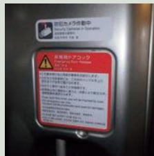
【新幹線の非常用ドアコック設置例】
