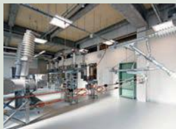
【新幹線電力訓練室】
