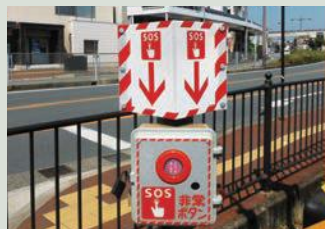
【非常ボタン（踏切支障報知装置）】
