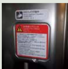
【新幹線の非常用ドアコック設置例】
