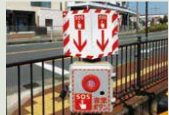
【非常ボタン（踏切支障報知装置）】
