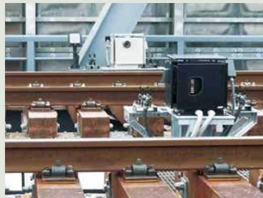
【新幹線台車温度検知装置】
