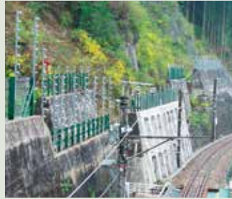
【落石止擁壁と落石警報装置】
