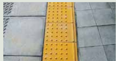
【内方線付き点状ブロック】
