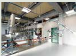
【新幹線電力訓練室】
