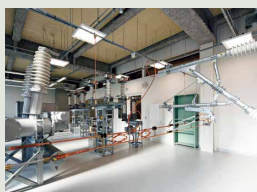
【新幹線電力訓練室】
