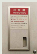
【在来線の非常用ドアコック設置例】
