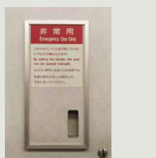
【在来線の非常用ドアロック設置例】
