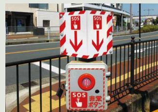
【非常ボタン（踏切支障報知装置）】
