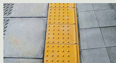
【内方線付き点状ブロック】
