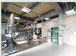
【新幹線電力訓練室】
