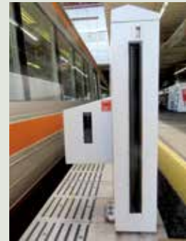
【在来線のホーム可動柵非常開ボタン】
