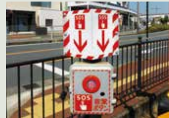
【非常ボタン（踏切支障報知装置）】
