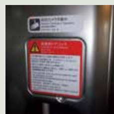
【新幹線の非常用ドアコック設置例】
