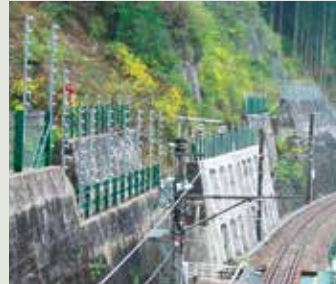
【落石止擁壁と落石警報装置】
