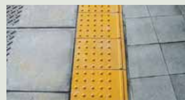
【内方線付き点状ブロック】
