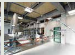
【新幹線電力訓練室】
