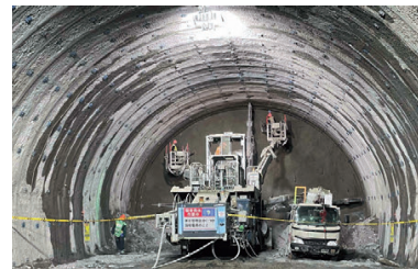
伊那山地トンネル（青木川工区） 本線トンネルの掘削（中央構造線部）
