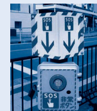
非常ボタン Emergency Button
