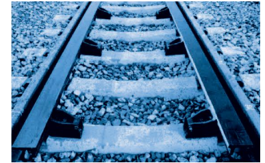
脱線防止ガード Derailment prevention guards
