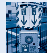
非常ボタン Emergency Button
