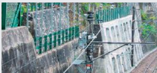
落石止擁壁と落石警報装置
