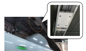
すり板検査装置
