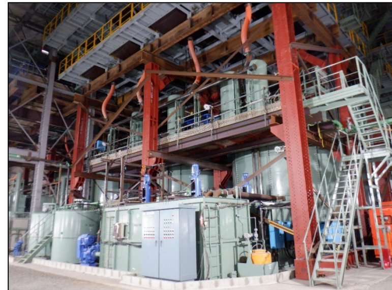
濁水処理設備
