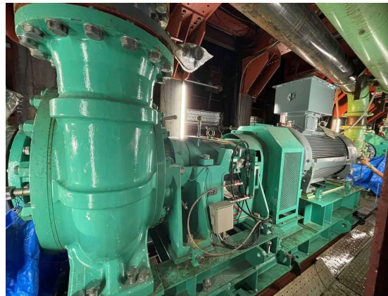
泥水を送るための設備
