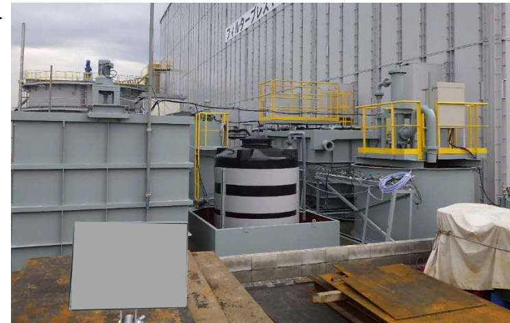
濁水処理設備
