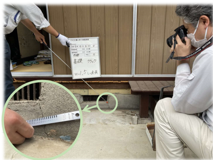
外壁・基礎調査
