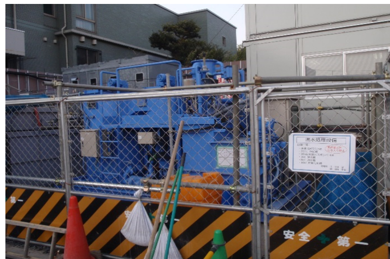
濁水処理設備
