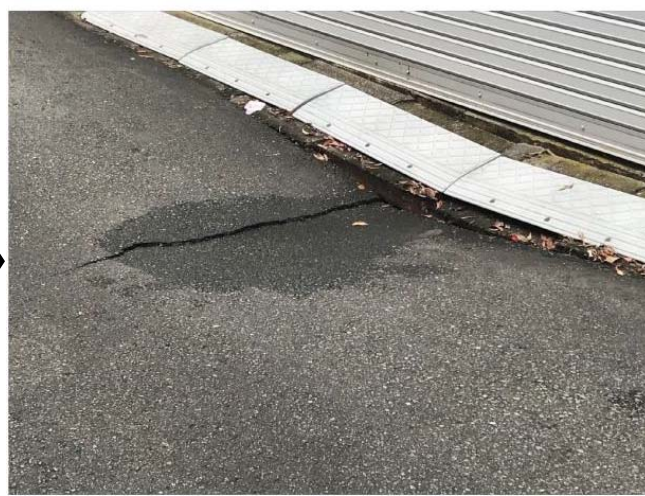
10月18日11:50(舗装亀裂)
