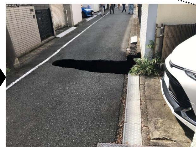
10月18日12:30(陥没箇所)
