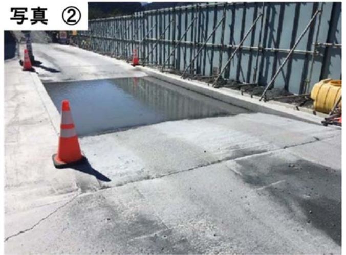
タイヤ洗浄設備の設置
