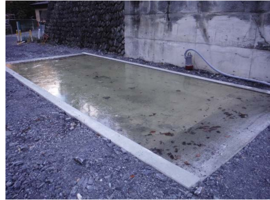
写真 6-4-4 タイヤ洗浄プール (雨畑地区発生土仮置き場)
