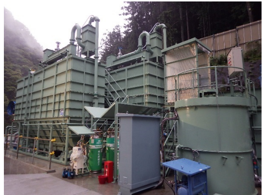
写真 6-2-10 濁水処理設備 (早川非常口)
