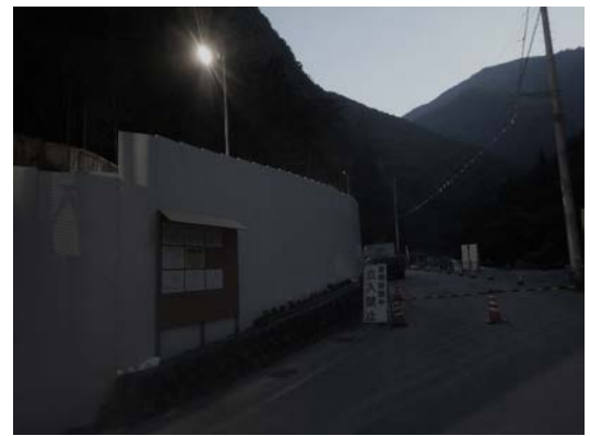
写真 6-2-18 LED 照明（点灯時） （早川非常口）
