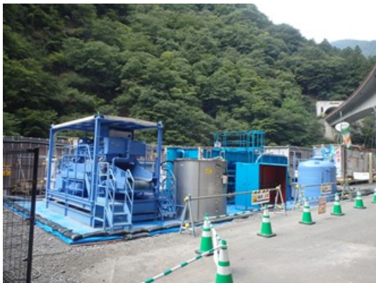
写真 6-1-9 濁水処理設備
