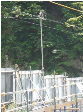
写真 6-2-17 LED 照明（点灯前） （早川非常口）
