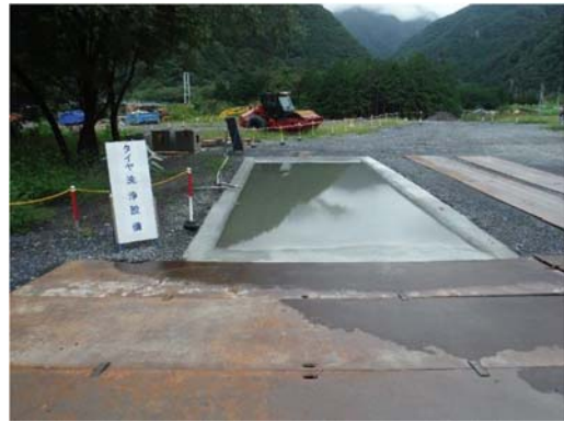
写真 6-3-4 タイヤ洗浄プール (塩島地区発生土置き場)
