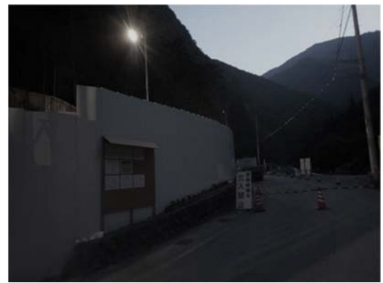
写真 6-2-18 LED 照明（点灯時）（早川非常口）
