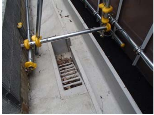
写真 6-1-12(1) 小動物が脱出可能な側溝
