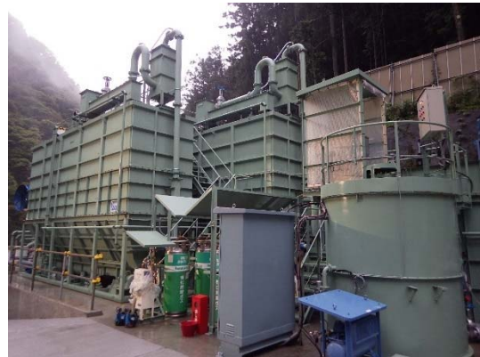
写真 6-2-10 濁水処理設備 (早川非常口)
