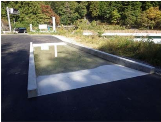
写真 6-2-9 タイヤ洗浄プール (広河原非常口入口)
