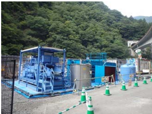
写真 6-1-9 濁水処理設備
