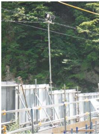
写真 6-2-17 LED 照明（点灯前）（早川非常口）
