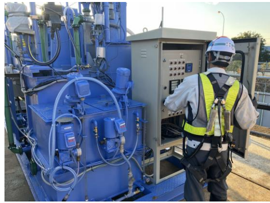
写真5-1-8 濁水処理設備の点検状況
