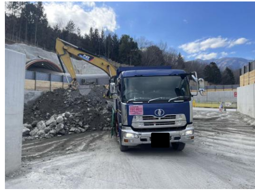
写真5-7-14 掘削土砂の適切な管理（底盤及び周辺のコンクリート打設）
