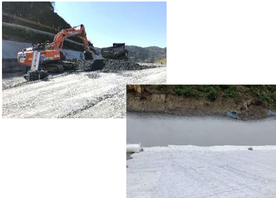
写真5-8-15 保守基地・変電所造成における 掘削土砂の適切な管理（二重遮水 シート、ゴムアスファルト設置）
