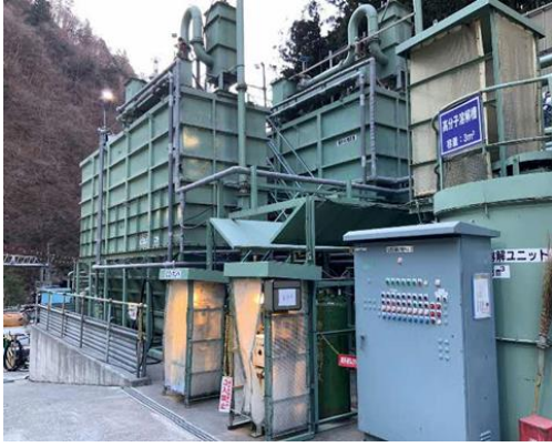
写真 5-11-12 濁水処理設備の設置状況 (早川非常口)
