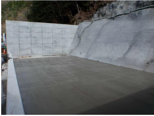
写真5-9-13 土砂ピットにおける掘削土砂の適切な管理状況（底盤及び周囲のコンクリート打設）
