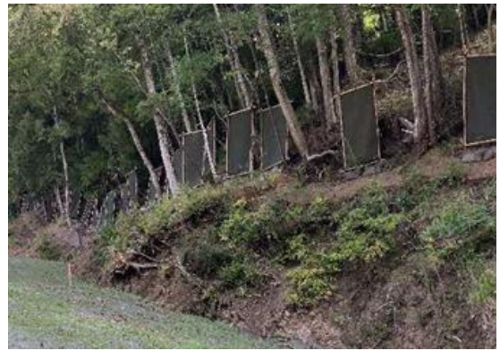
写真 5-8-20 工事施工ヤード等の林縁保護 植栽等による重要な種の生息 環境の確保（壁面緑化材設置）
