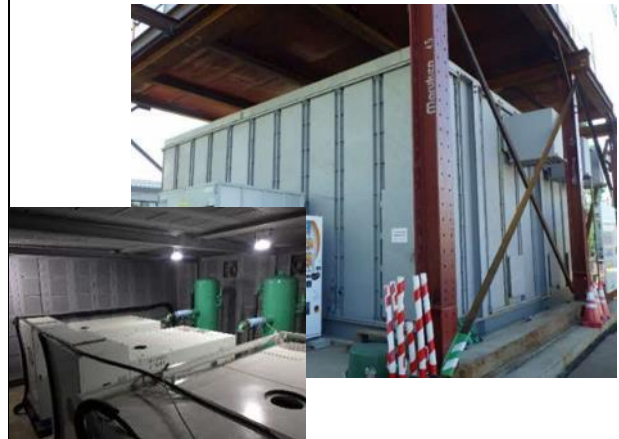
写真5-5-12 空気圧縮機の防音ハウス内 への設置状況
