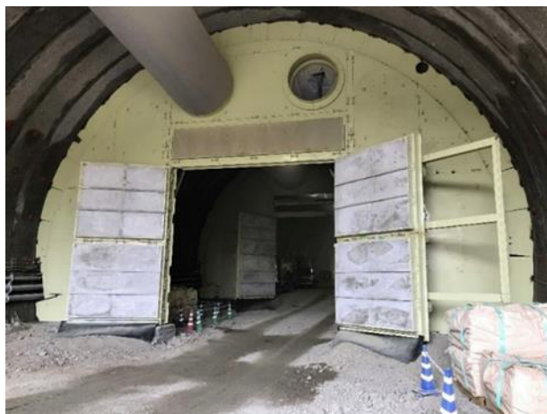
写真 7-5-1 二重構造にした本線トンネル坑口部防音扉（第四南巨摩トンネル品川方坑口部）
