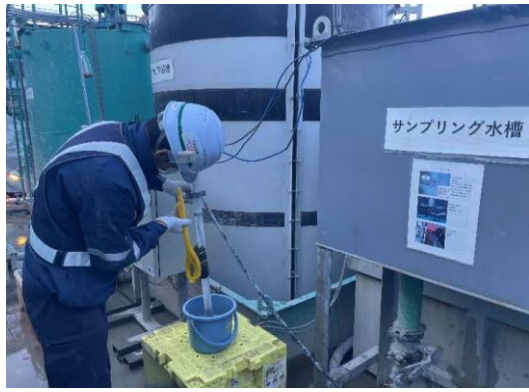
写真5-7-13 処理装置の点検・整備による性能維持
