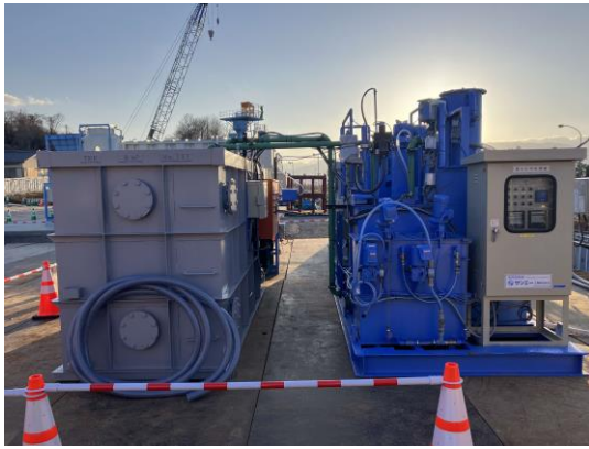
写真5-1-7 濁水処理設備の設置状況
