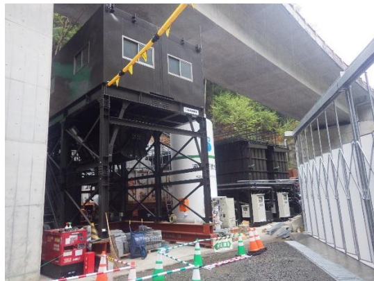
写真5-9-11 濁水処理設備の設置状況
