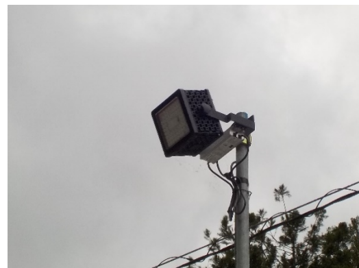
写真 6-5-17(2) LED 照明 (早川非常口)
