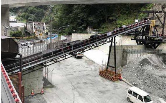
写真6-4-15 仮設物の色合いへの配慮 (ベルトコンベアー)
