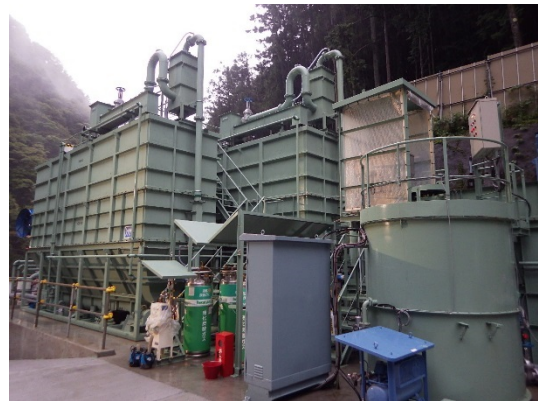
写真 6-5-10 濁水処理設備 (早川非常口)
