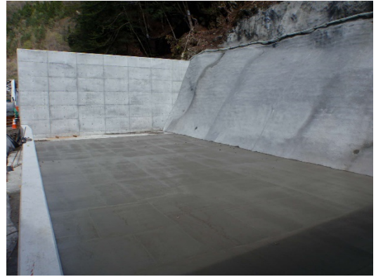
写真6-4-11(2) 土砂ピットにおける掘削土砂の管理（底盤及び周囲のコンクリート打設）
