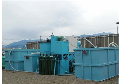
写真6-1-9 濁水処理設備
