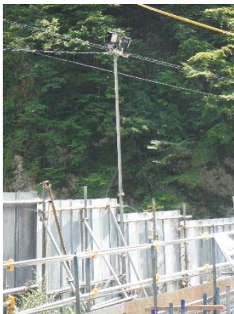
写真 6-5-17(1) LED 照明 (点灯前) (早川非常口)
