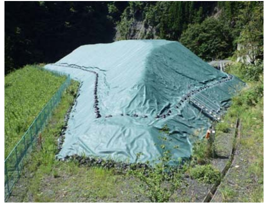
写真 6-7-8 遮水シート (雨畑発生土仮置き場)
