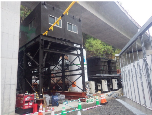
写真6-4-9 濁水処理設備
