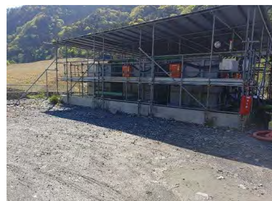
写真 4-1-11-4 工事排水の適切な処理 (浸潤水用水槽の設置状況) (西之宮地区(その2)発生土仮置き場)
