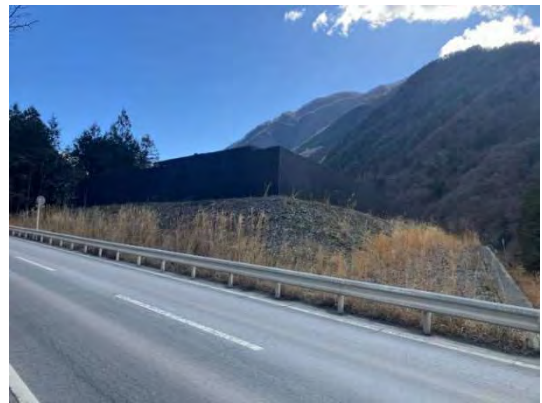
写真 4-1-10-2 仮囲いの設置、仮囲い・防音パネル等の設置による遮音対策、防音シート、低騒音型の建設機械の採用
