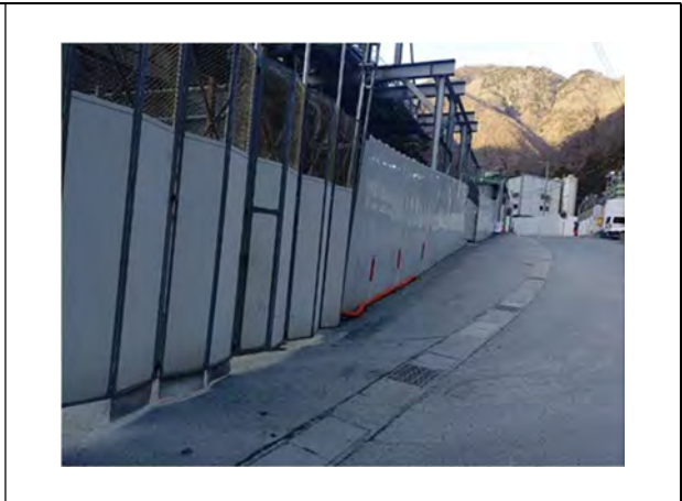
写真 4-1-9-2 仮囲いの設置、仮囲い・防音シート等の設置による遮音対策、侵入防止柵の設置
