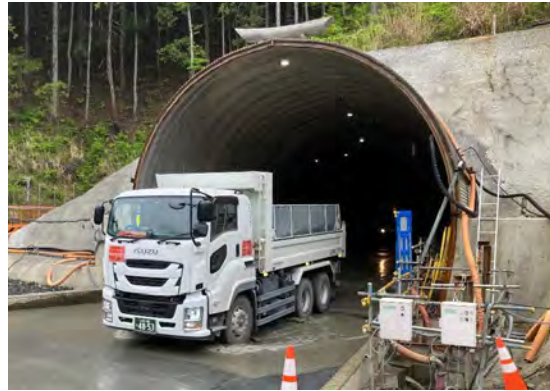
写真 4-1-6-22 タイヤの洗浄、資材及び機械の運搬に用いる車両の出入口、周辺道路の清掃及び散水、タイヤの洗浄 (タイヤの洗浄)
