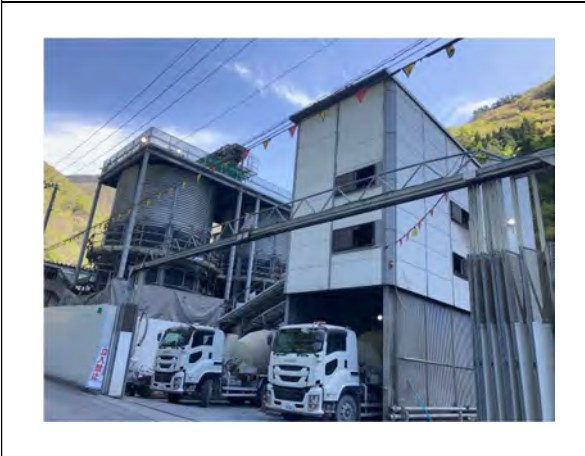
写真 4-1-9-3 仮囲い・防音シート等の設置による遮音対策、防音シート、低騒音型の建設機械の採用 (バッチャープラントへの建屋の設置)
