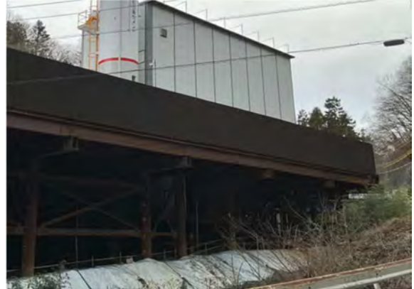
写真 4-1-5-2 仮囲いの設置、仮囲い・防音シート等の設置による遮音対策
