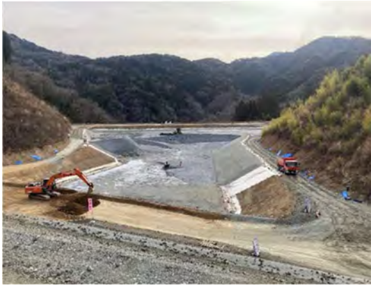
写真 4-1-6-13 保守基地・変電所造成における掘削土砂の適切な管理
