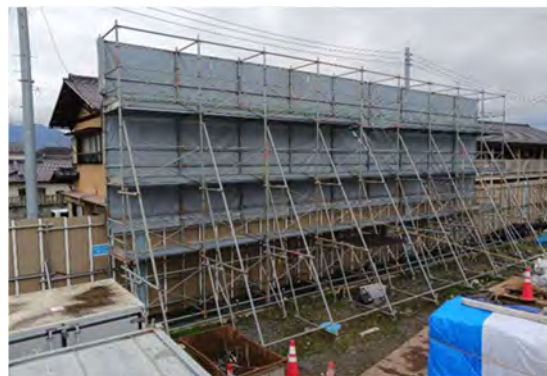
写真 4-1-3-2 仮囲いの設置、仮囲い・防音シート等の設置による遮音対策
