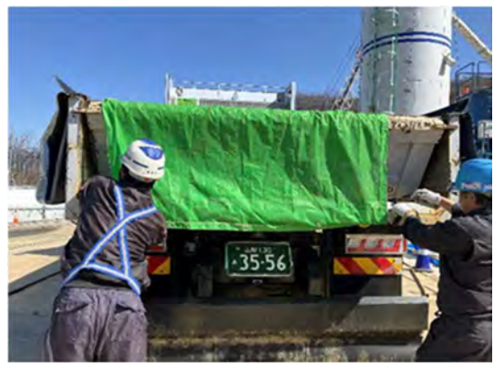
写真 4-1-1-12 荷台への防じんシート敷設及 び散水 (防じんシートの敷設)
