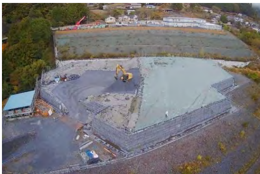
写真 4-1-11-5 仮置き場における掘削土砂の適切な管理 (遮水シートの設置状況) (西之宮地区(その2)発生土仮置き場)
