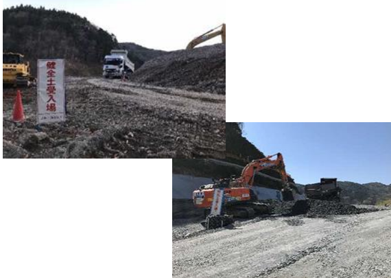
写真4-1-7-11 保守基地・変電所造成における掘削土砂の適切な管理
