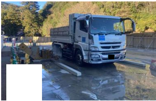
写真 4-1-7-15 タイヤ洗浄機の設置状況
