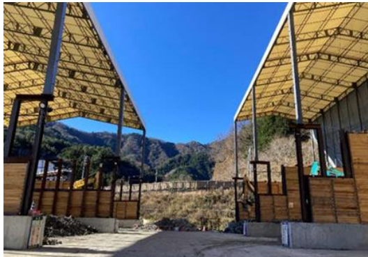
写真4-1-7-9 土砂ピットにおける掘削土砂の適切な管理状況（底盤及び周辺にコンクリート打設）
