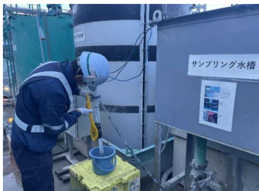
写真4-1-6-11 処理装置の点検・整備による 性能維持
