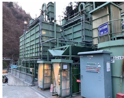
写真 4-1-9-11 濁水処理設備の設置状況 (早川非常口)
