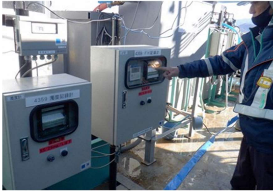
写真4-1-5-12 処理装置の点検・整備による性能維持
