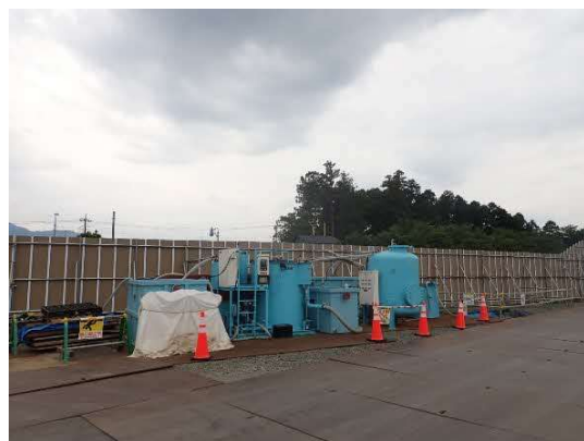
写真4-1-4-11 濁水処理設備状況
