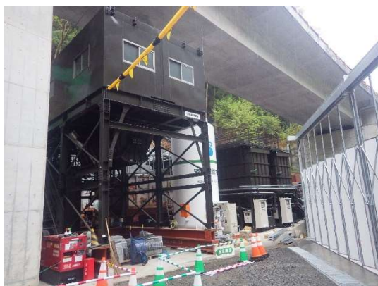
写真4-1-7-10 濁水処理設備の設置状況
