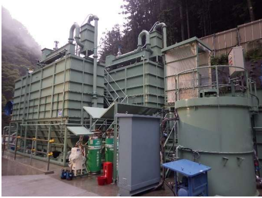
写真 4-1-8-12 濁水処理設備の設置状況 (早川非常口)
