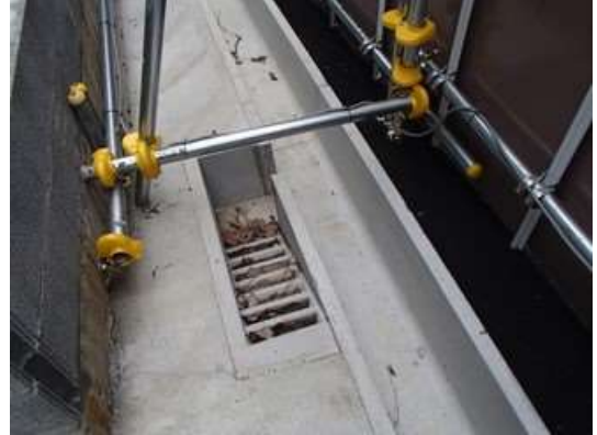
写真4-1-7-13(1) 小動物が脱出可能な側溝
