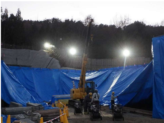
写真4-1-5-16 照明の漏れ出しの抑制
