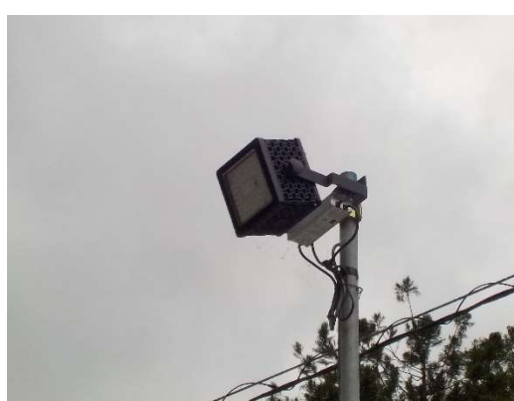
写真4-1-8-17 LED照明による照明の 漏れ出しの抑制 (早川非常口)
