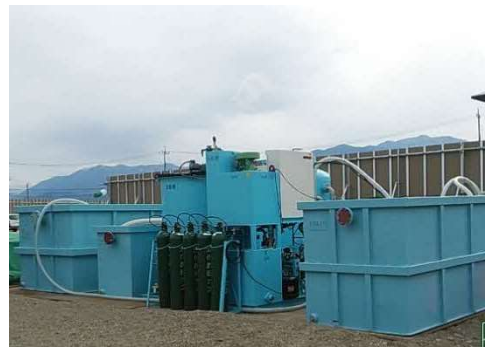
写真4-1-3-9 濁水処理設備の設置 状況
