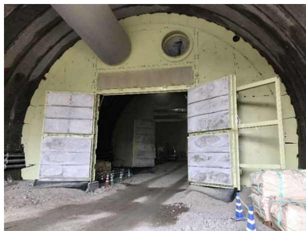
写真参 7-3-1 本坑防音扉 2重構造
