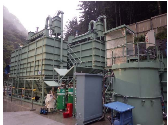
写真4-1-2-10 濁水処理設備 (早川非常口)
