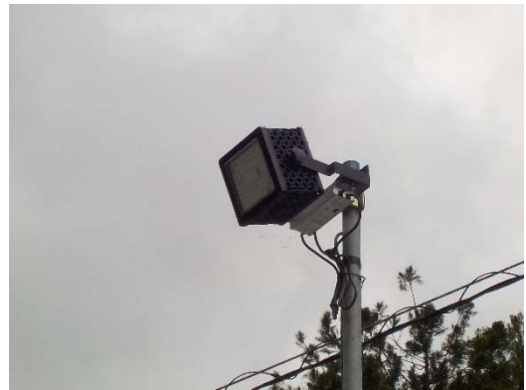
写真4-1-2-17(2) LED照明 (早川非常口)
