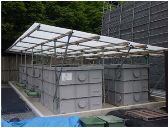
写真4-1-4-7 浸潤水用水槽 (塩島(下流)発生土仮置き場)
