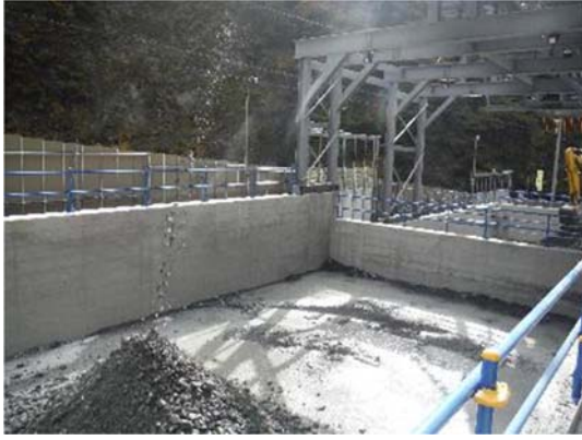
写真4-1-2-13 土砂ピットにおける 掘削土砂管理 (底盤及び周囲のコンクリート打設) (早川非常口)
