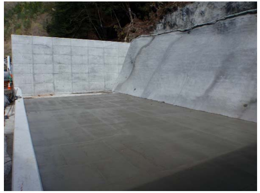
写真4-1-1-11(2) 土砂ピットにおける掘 削土砂の管理（底盤及び周 囲のコンクリート打設）
