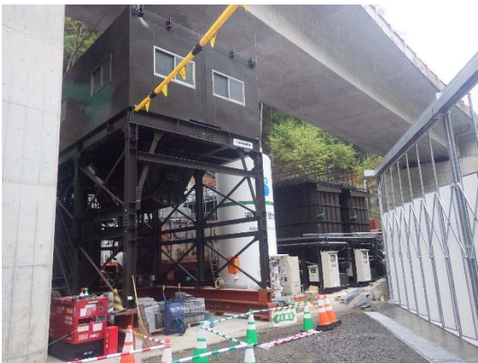
写真4-1-1-9 濁水処理設備
