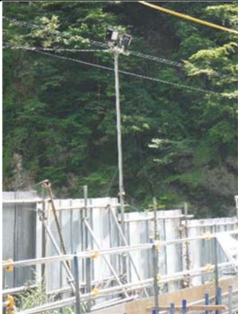
写真4-1-2-17(1) LED照明 (点灯前) (早川非常口)
