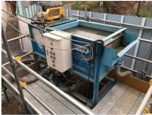
写真-3 濁水処理設備の設置状況（地点 02）
