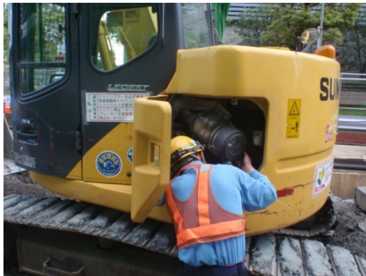
写真-3-1 建設機械の点検及び整備による 性能維持状況 (地点 01)
