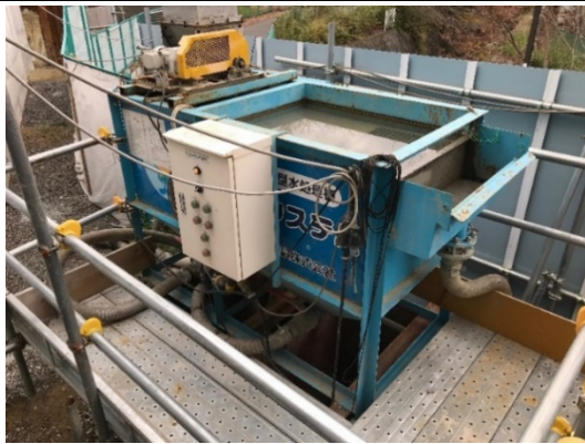
写真-3 濁水処理設備の設置状況（地点 02）
