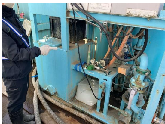
写真 4-1-4-10 処理設備の点検・整備による性能維持
