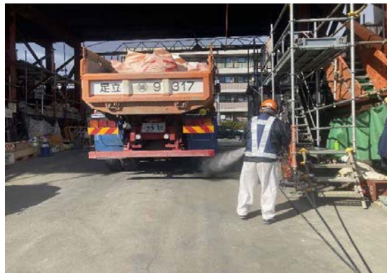
写真 4-1-3-14 資材及び機械の運搬に用いる車両の出入口、周辺道路の清掃及び散水、タイヤの洗浄
