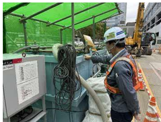
写真 4-1-1-8 処理設備の点検・整備による性能維持
