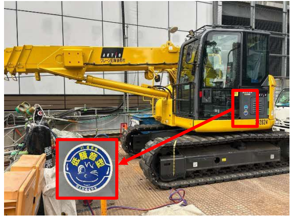
写真 4-1-1-2 排出ガス対策型建設機械の採用、低騒音型建設機械の採用、建設機械使用時における配慮
