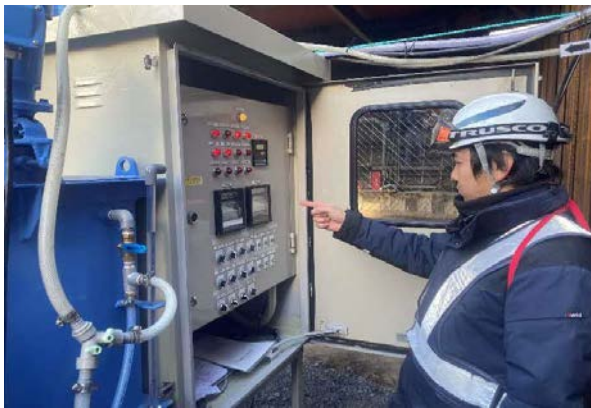
写真 4-1-3-9 処理設備の点検・整備による性能維持
