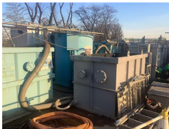
写真 4-1-4-13 濁水処理設備の設置
