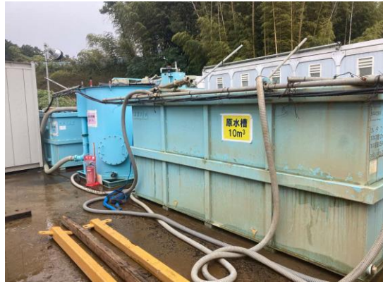
写真 4-1-5-13 濁水処理設備の設置
