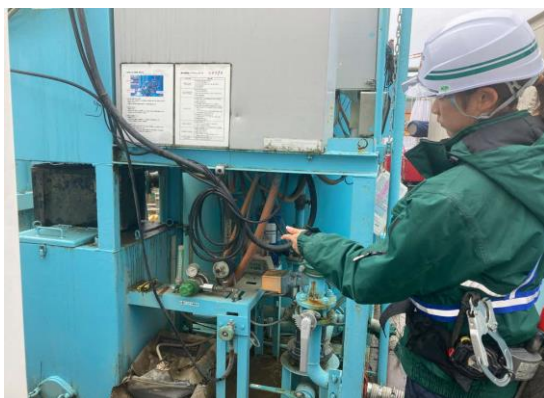
写真 4-1-5-10 処理設備の点検・整備による性能維持
