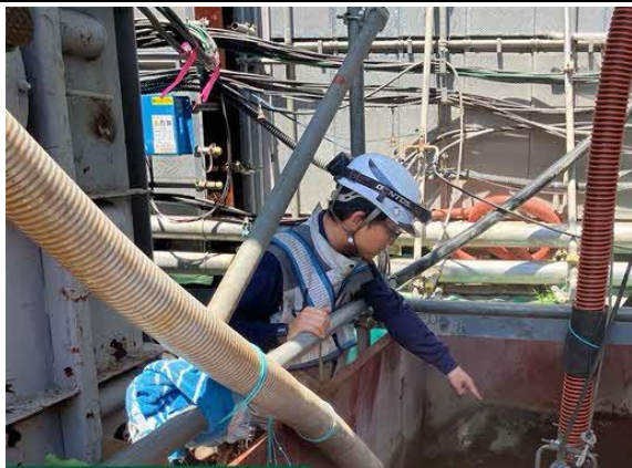
写真 4-1-2-9 処理設備の点検・整備による性能維持
