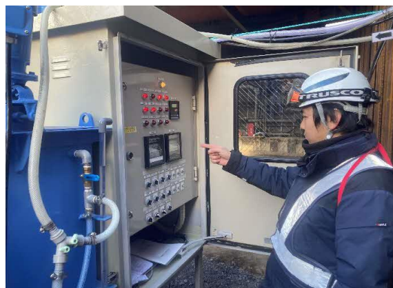
写真 4-1-4-14 処理設備の点検・整備による性能維持
