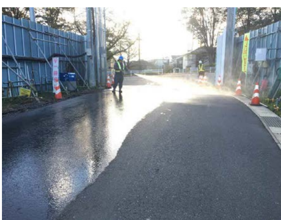
写真4-1-6-4 工事現場の清掃、散水、資材及び機械の運搬に用いる車両の出入り口、周辺道路の清掃及び散水、タイヤ洗浄
