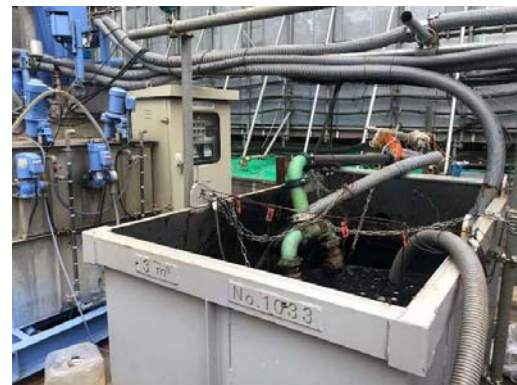
写真4-1-2-6 下水道への排水
