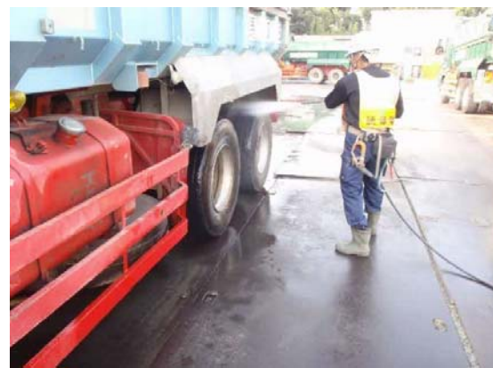
写真4-1-3-12 資材及び機械の運搬に用いる車両の出入口、周辺道路の清掃及び散水、タイヤの洗浄
