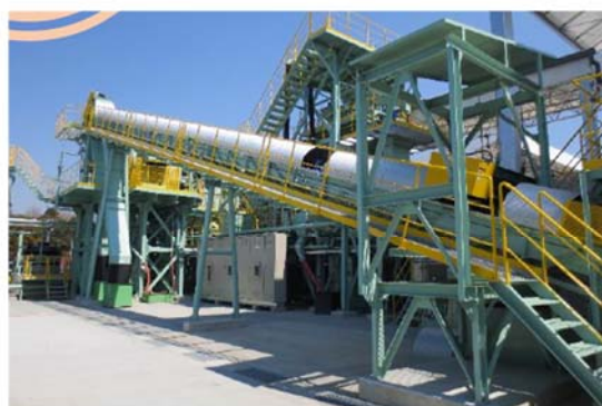
洗浄処理施設
