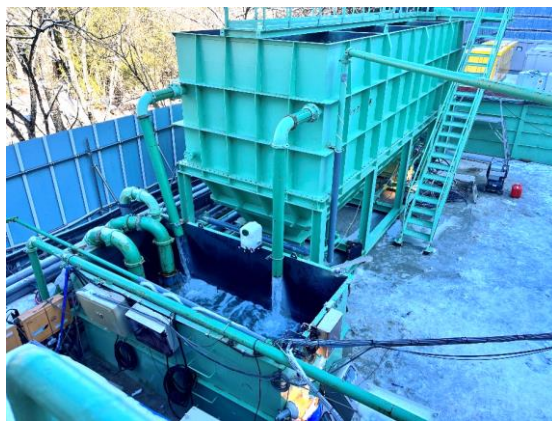
写真4-1-158 濁水処理設備の設置状況
