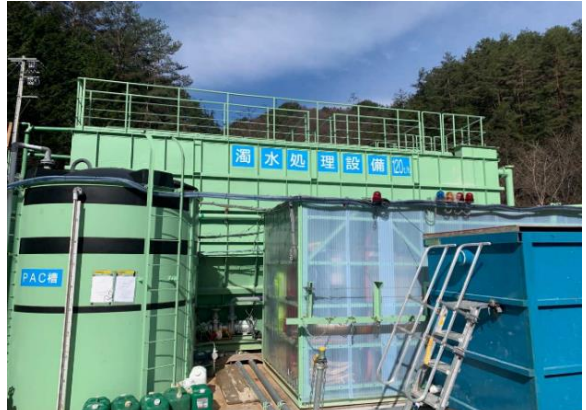
写真4-1-53 濁水処理設備の設置状況
