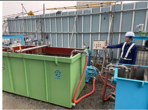
写真4-1-93 処理装置又は排水設備の点検
