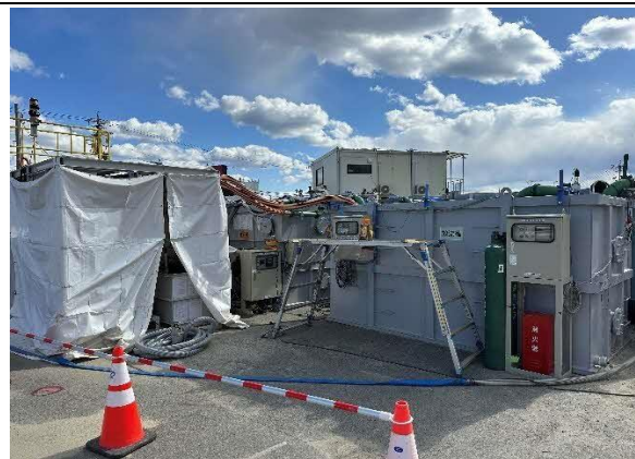
写真4-1-115 濁水処理設備の設置状況
