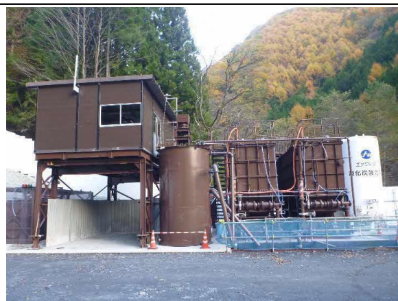
写真4-1-7 濁水処理設備の設置状況
