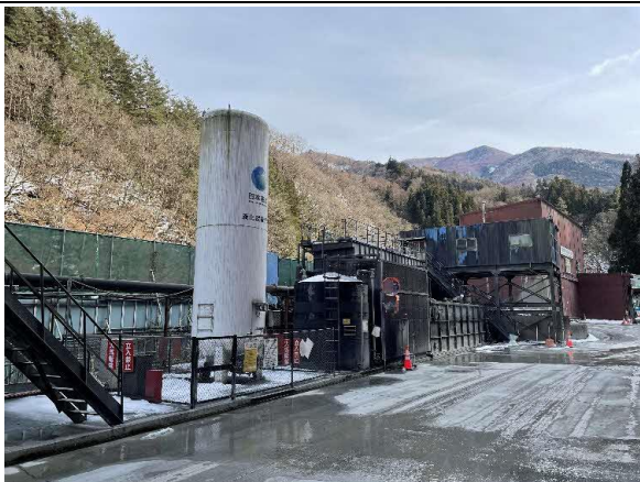
写真4-1-30 濁水処理設備の設置状況
