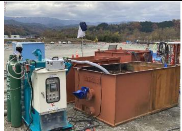
写真4-1-102 中和処理装置及び沈砂池の設置状況
