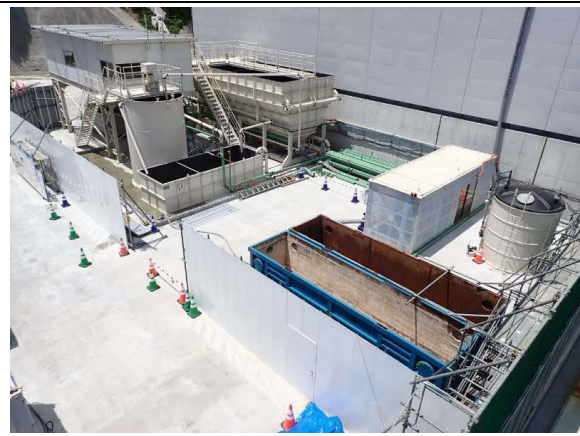
写真4-1-136 濁水処理設備の設置状況
