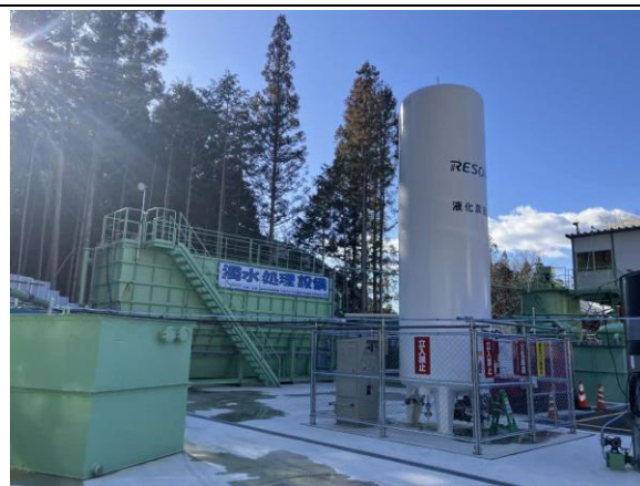
写真4-1-178 濁水処理設備の設置状況
