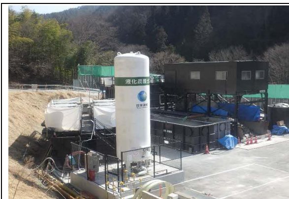
写真4-1-73 濁水処理設備の設置状況
