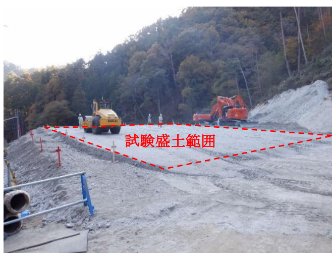
※写真は中央新幹線伊那山地トンネル新設(戸中・壬生沢工区)における類似工事の例を示している。
