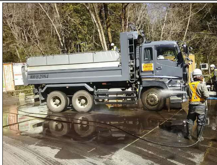
※図に添付されている写真は、長竹非常口工事の実施例である
