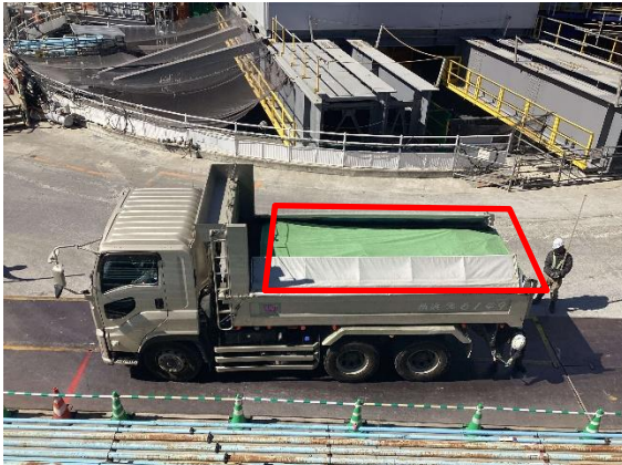
写真 4-1-4-11 荷台への防じんシート敷設及び散水 (防じんシートの敷設)
