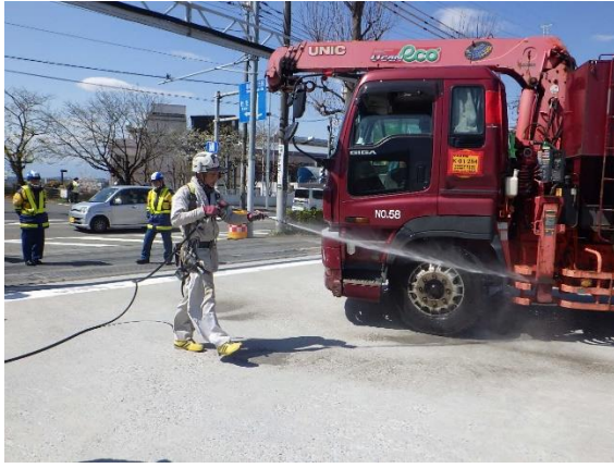
写真 4-1-4-12 資材及び機械の運搬に用いる 車両の出入り口等の清掃、 散水及びタイヤの洗浄
