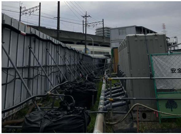
写真4-1-6-7 下水道への排水
