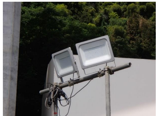
写真 4-1-9-18 照明の漏れ出しの抑制等 (LED ライトの使用)
