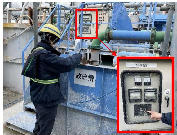
写真4-1-2-13 処理設備の点検・整備による性能維持
