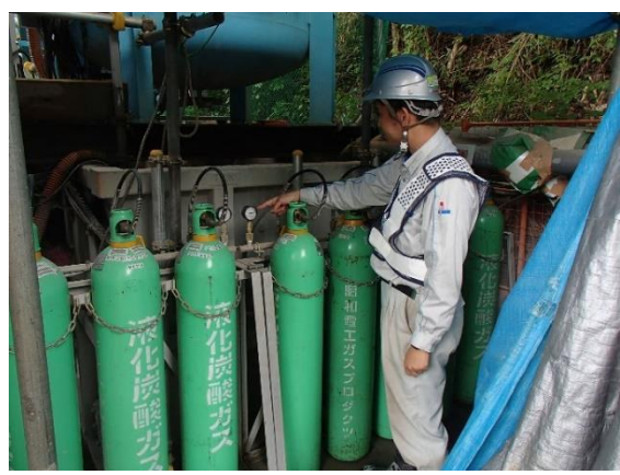
写真 4-1-9-12 処理設備の点検・整備による性能維持
