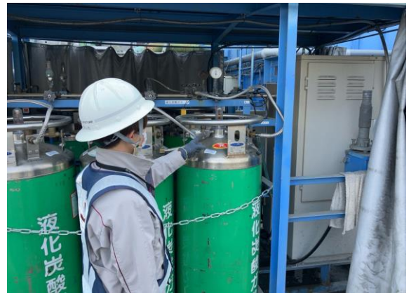
写真4-1-10-10 処理設備の点検・整備による性能維持
