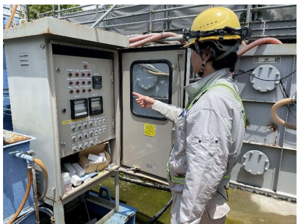
写真4-1-1-3 処理設備の点検・整備による性能維持
