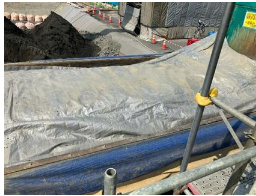
写真4-1-5-7 荷台への防じんシート敷設及び散水 (防じんシートの敷設)
