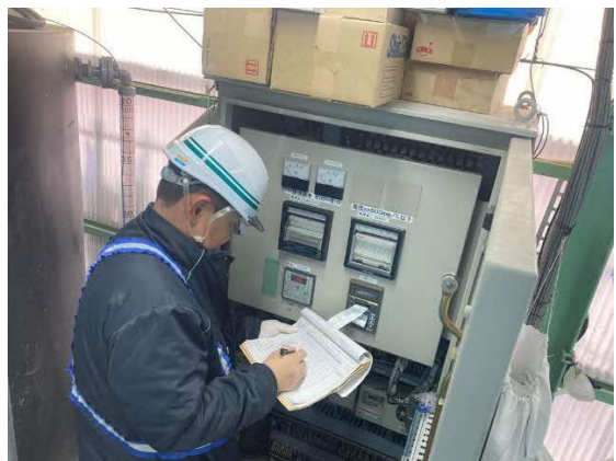
写真 4-1-4-8 処理設備の点検・整備による性能維持
