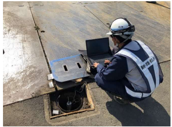
写真4-1-5-8 地下水の継続的な監視 (常時計測のデータ監視の様子)
