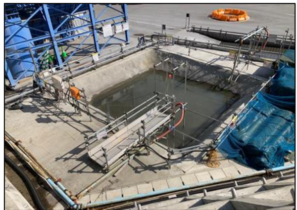
写真② 仮設沈砂池
