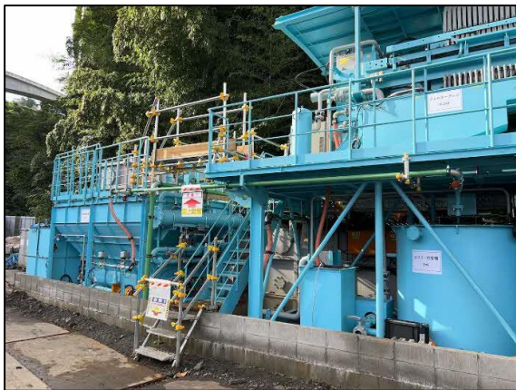
写真① 濁水処理設備
