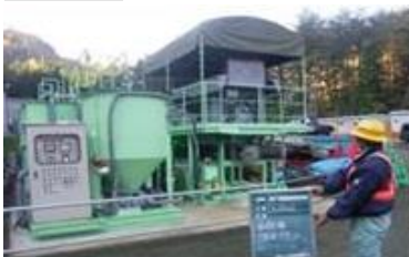
機械式脱水処理装置
