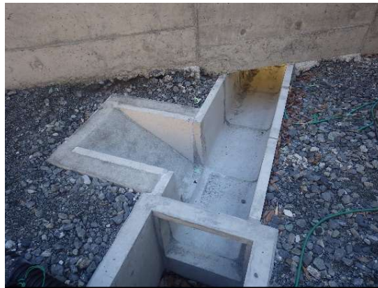
小動物等が脱出可能なスロープ
