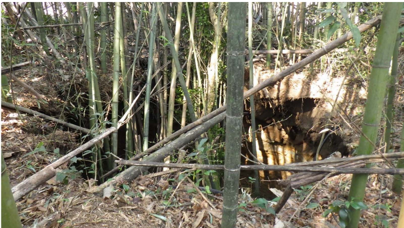
地上部土砂崩落状況 (平成 31 年 4 月 8 日撮影)
