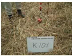
幅杭設置 建設用地の幅を示すため 計画路線に沿って両側に 杭を設置します。
